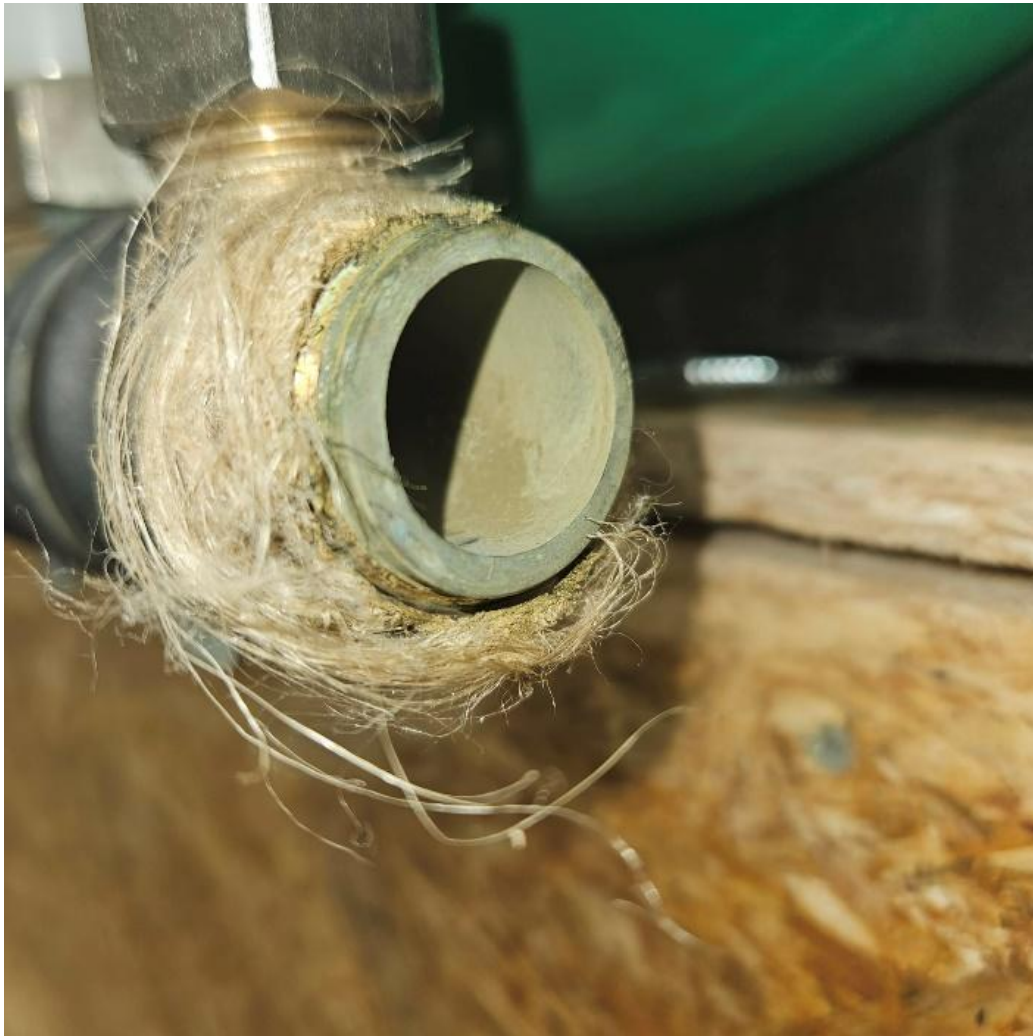
Figur 9: Samlestokk som er tappet ned og korrodert (Eget foto, 2025)
